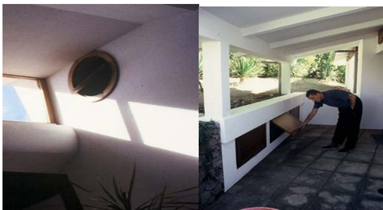
Figura5.6 – Mecanismos de controlo das chaminés solares (à esquerda) e do sistema de tubos enterrados (à direita) (Autor: C. Magro).
