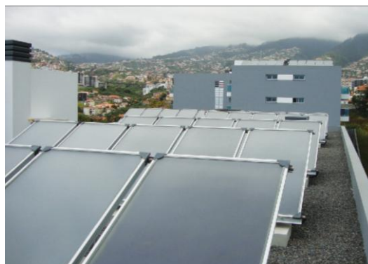
Figura 76 - Cobertura com os painéis solares (Gonçalo Camacho, 2010)
