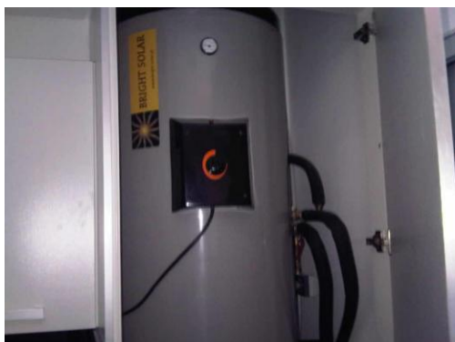
Figura 75 - Depósito Acumulador (Gonçalo Camacho, 2010)
