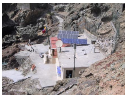
Figura 19 - Instalação solar térmica e fotovoltaica nas Ilhas Selvagens (Arquivo Parque Natural da Madeira, 2010)
