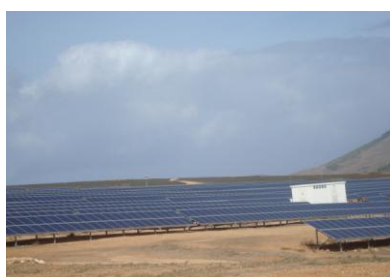
Figura 18 - Parque fotovoltaico em Porto Santo construído em 2010 (Gonçalo Camacho, 2010)
