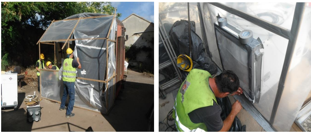
Figura 5.23 – Estrutura improvisada de Madeira zona confinada vista pelo exterior e pelo interior.
