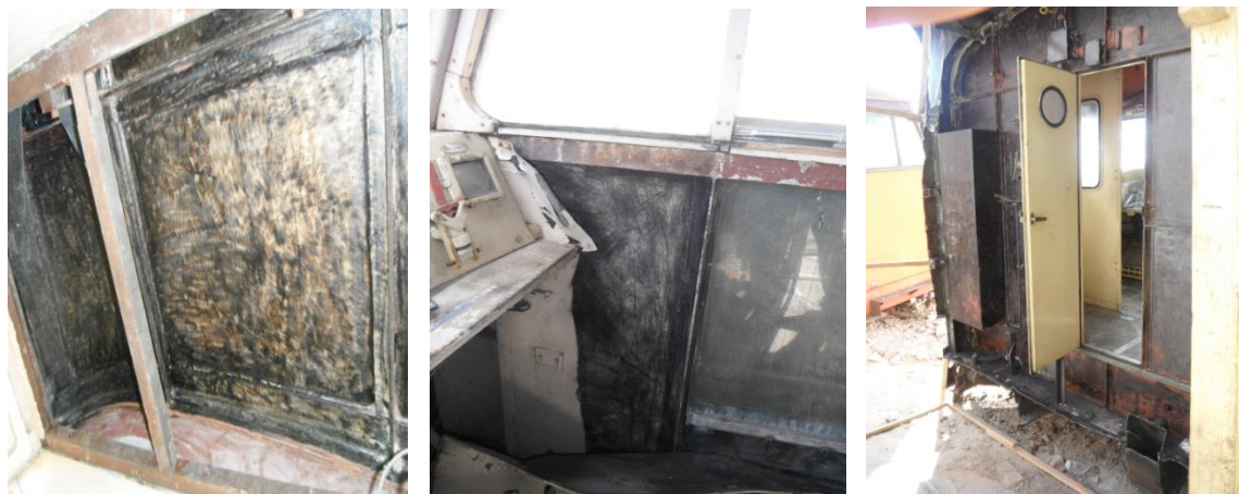
Figura 5.31 – Teto, painéis laterais e traseira da cabine isentos de amianto.
