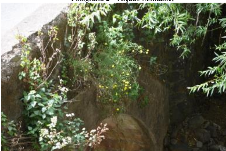
Fotografia 3 – Pormenor Vegetação, Muro timpano, Arco e Guarda Corpos;
