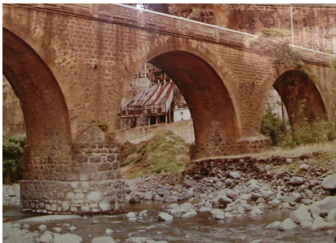
Figura 84 – Erosão do pilar e presença de vegetação [26];
