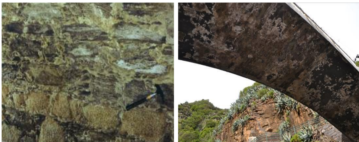
Figura 40 - Degradação do material pétreo. [11] (esq); Ponte Ramal do Caminho Real Nº 23, degradação do revestimento e blocos de alvenaria no extradorso do arco (dir.);
