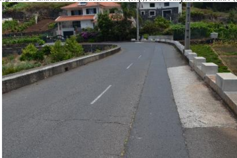
Fotografia 3 – Pavimento com Camada de Betuminoso e em Betão; Guarda Corpos;
