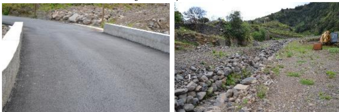
Fotografia 3 – Pavimento Guarda Corpos (esq.); Curso de Água (dir.);
