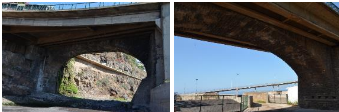
Fotografia 2 – Arco, Muro Tímpano e Ampliação da Via (esq.) Estradorso do Arco (esq.);
