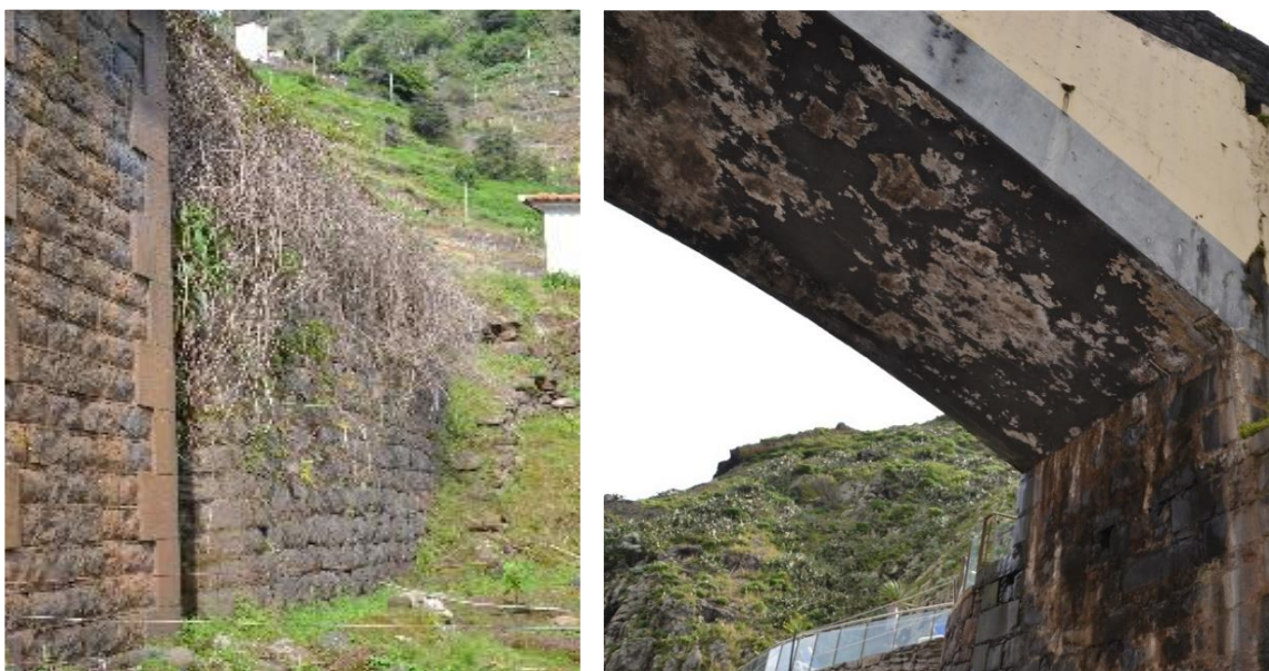
Figura 30 – Presença de vegetação no encontro, Ponte do Faial I (esq.); Presença de humidade no encontro, Ponte do Faial II (dir.);
