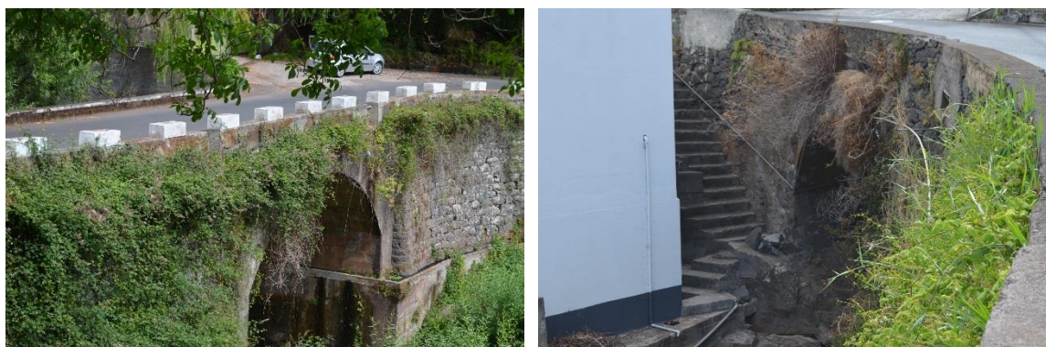
Figura 36 – Vegetação presente nas estruturas de alvenaria de pedra;
