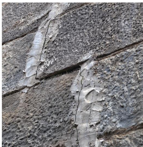
Figura 33 – Fendilhação no encontro da Ponte Ribeira da Janela (esq.);
