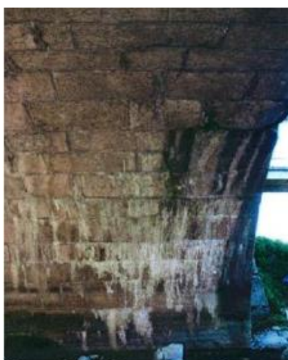
Figura 38 – Presença de eflorescências e escorrências de água no intradorso da ponte [7];
