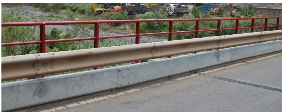
Figura 86 – Guardas metálicos e perfis de segurança;
