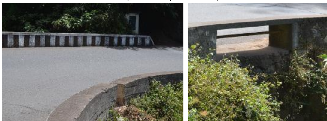
Fotografia 3 – Pavimento, Guarda Corps (esq.); Pormenor abertura no guarda corpos (dir.);
