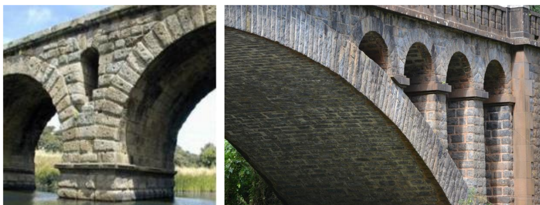
Figura 12 – Apresentação de olhais sob o pilar (esq.) [7]; Arcos secundários, Ponte ER101 São Jorge (dir.);
