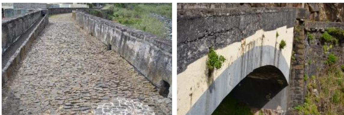
Fotografia 3 – Pavimento com Alvenaria de Pedra (esq.); Guarda Corpos e Extradorso do Arco (dir.);
