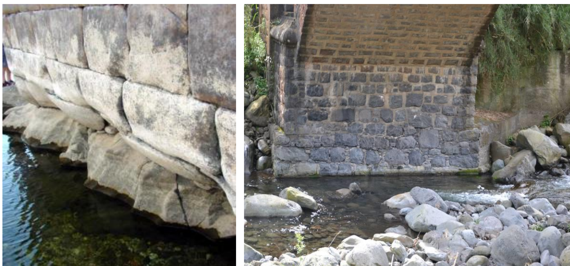
Figura 31 – Erosão da fundação num apoio da ponte de alvenaria de pedra [12];
