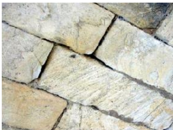
Figura 39 - Perda de argamassa nas juntas [12];
