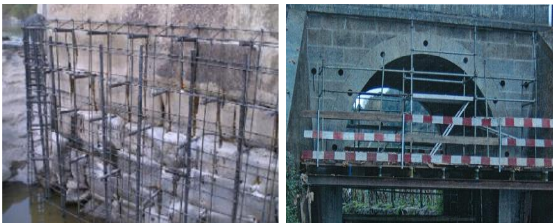
Figura 43 – Execução de pregagens em torno do pilar (esq.) [12]; Execução de tirantes num arco (dir.) [7];
