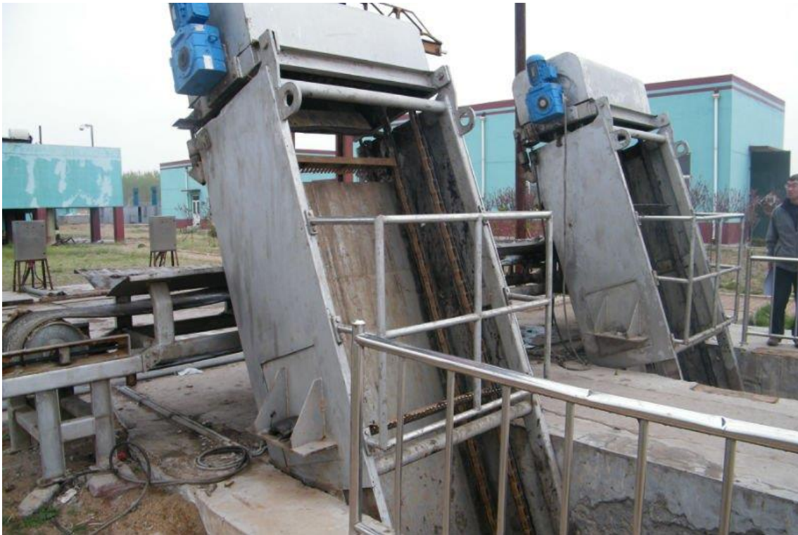
Figura 12 - Grades com dentes de limpeza suspensos por correntes
