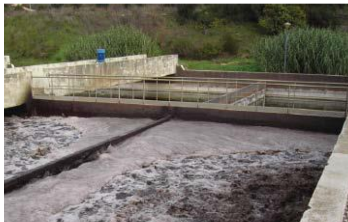
Figura 26 - Sistema de tratamento biológico por lamas ativadas
