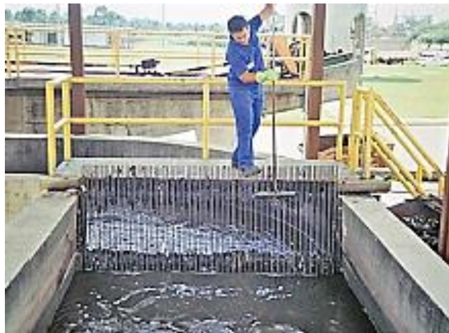
Figura 8 - Grades de barras de limpeza manual
