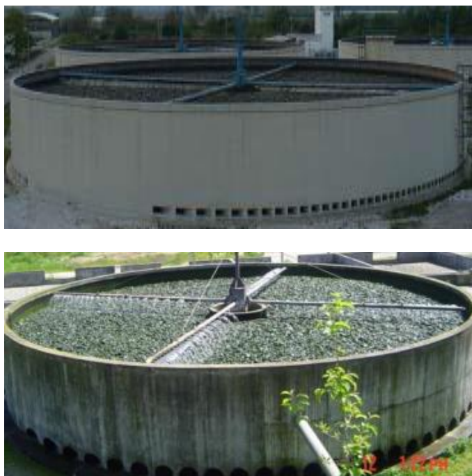
Figura 28 - Sistema de tratamento biológico por leitões percoladores
