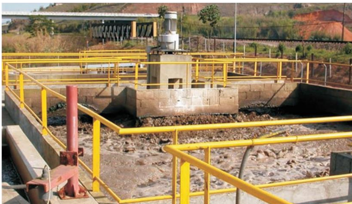
Figura 35 - Reator biológico (tanque de arejamento)
