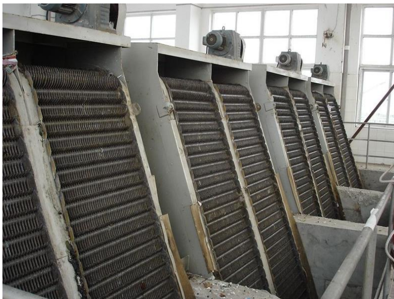
Figura 13 - Grades contínuas de auto-limpeza
