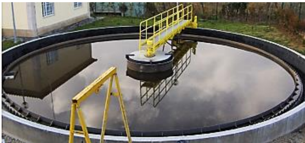
Figura 22 - Tanque de sedimentação circular
