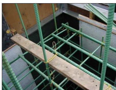
Figura 54 - Armaduras com película de base epóxi (Polito, 2006).
