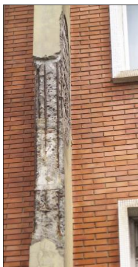
Figura 9 - Corrosão generalizada num pilar (Minuzzi, 2007).
