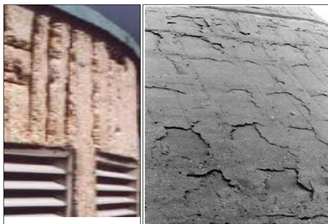
Figura 15 - Destacamento do betão carbonatado após corrosão das armaduras (esquerda). Padrão de fissuração segundo a malha de armaduras, devido à carbonatação (direita) (Simas, 2007).
