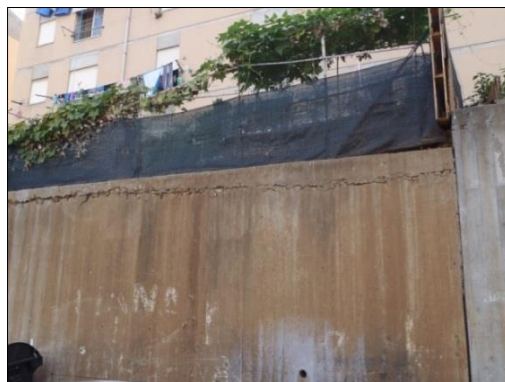
Figura 62 - Destacamento da camada do coroamento do muro "M 14a".
