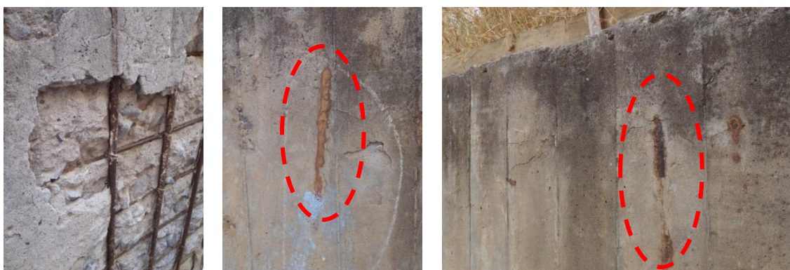
Figura 84 - Insuficiência de espessura de recobrimento.
