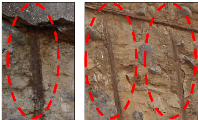
Figura 83 - Perda de secção por corrosão induzida pela presença de cloretos.
