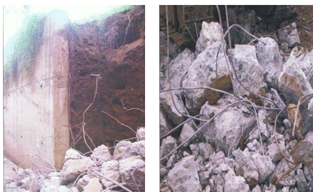
Figura 64 - Muro que ruiu.
