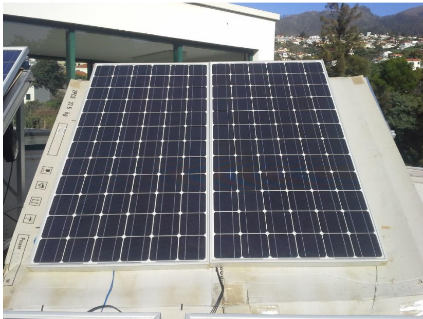
Fig. G.14 – Fotografia dos painéis fotovoltaicos.
