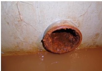
Tubagem para água da rede de combate a incêndio
