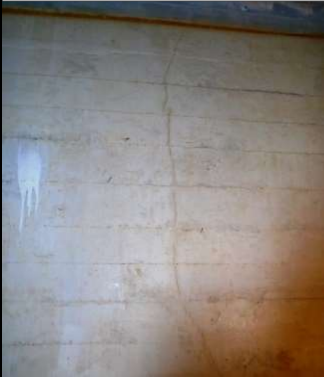
Figura 9 - Fissura na parede interior
