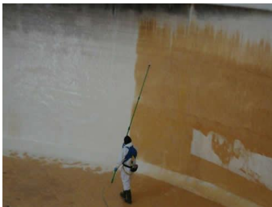
Figura 61 – Lavagem e desinfecção de reservatório
