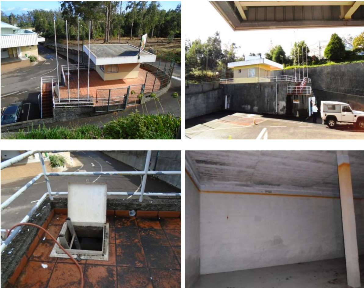
Figura 44 – Reservatório do CASA
