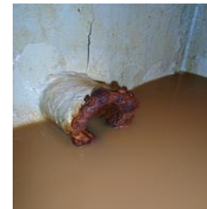
Tubagem para a descarga de fundo
