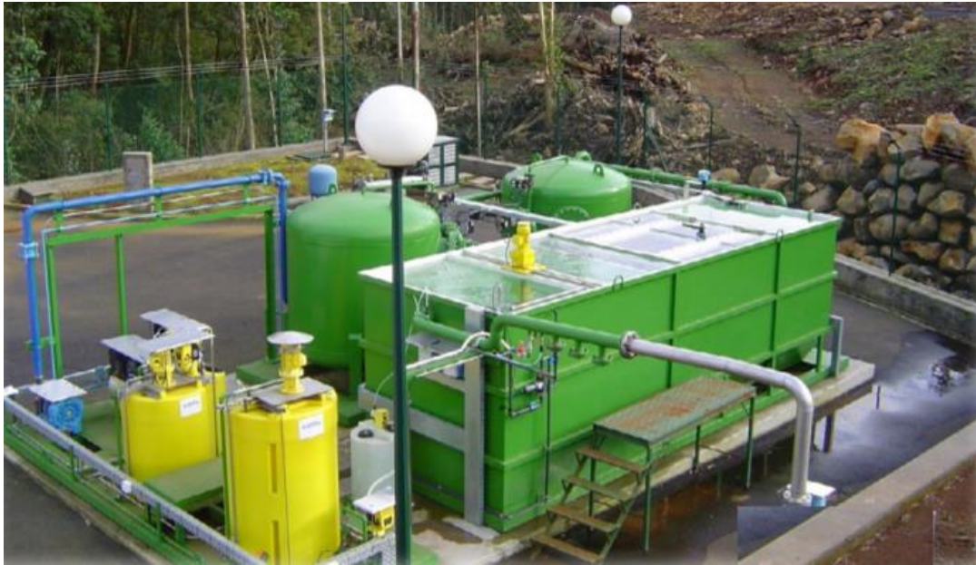
Figura 5 – Estação Elevatória da ETA do Santo da Serra (fonte: www.aguasdmadeira.pt )
