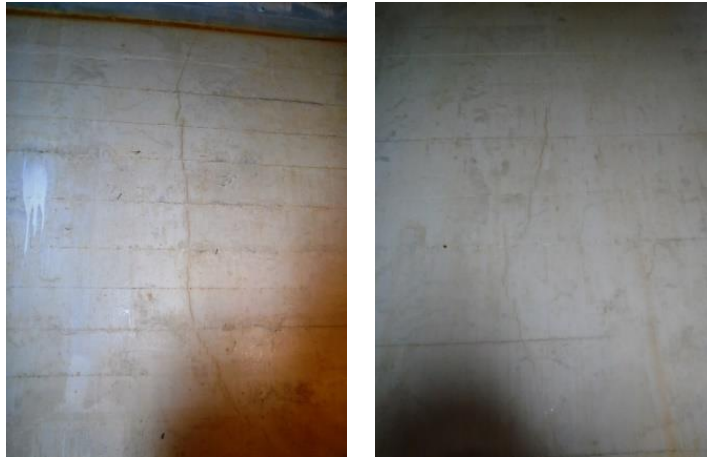
Figura 46 – Aparecimento de fissuras
