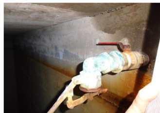
Torneira de boia e válvula de esfera (entrada de água)
