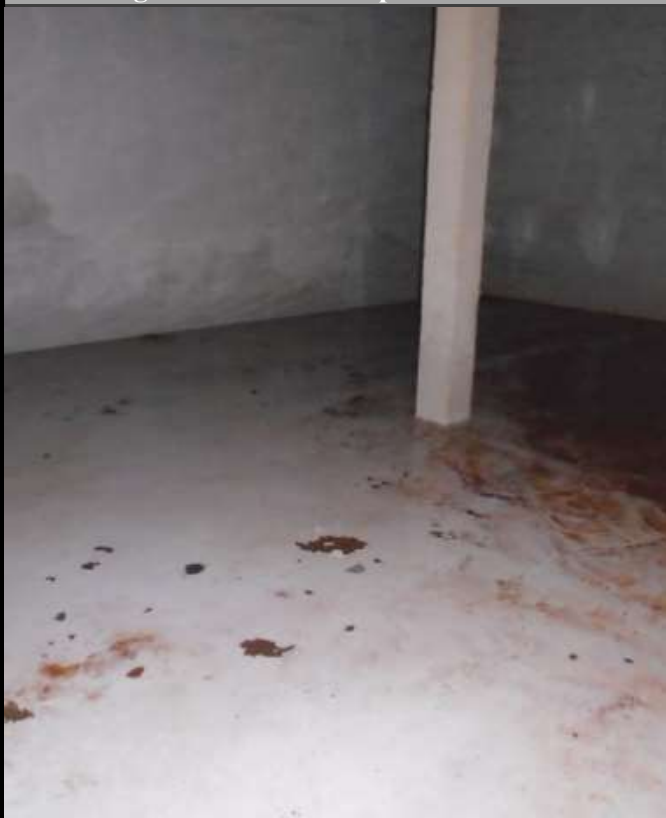
Figura 11 - Degradação do revestimento
