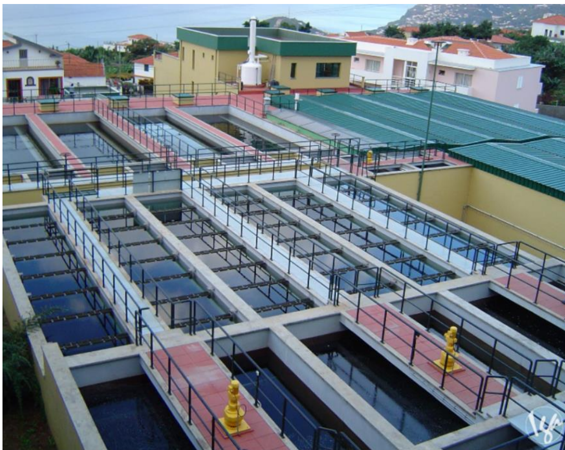
Figura 7 – ETA de Santa Quitéria (fonte: www.aguasdamaideira.pt )
