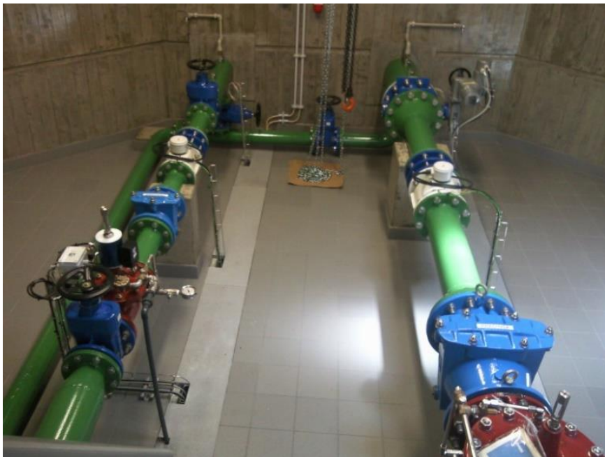
Figura 9 – Equipamento de distribuição (fonte: www.socopul.pt )
