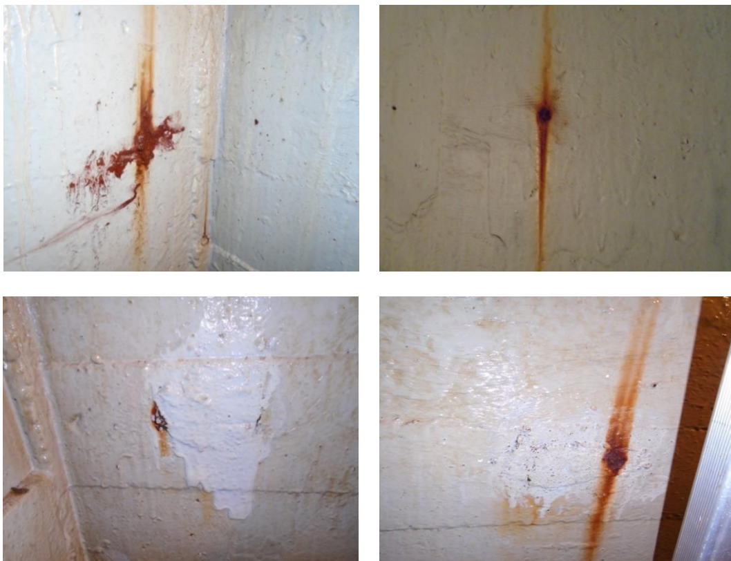
Figura 45 – Corrosão de esticadores (em zonas pontuais)
