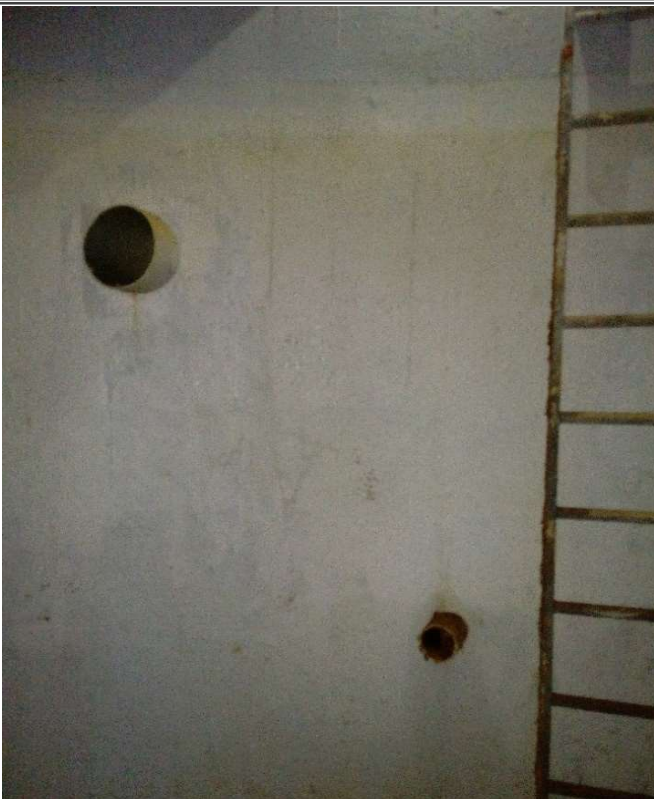
Figura 4 - Tubagens de entrada e saída
