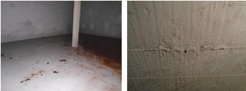
Figura 47 – Degradação do revestimento interior de paredes e pavimento
