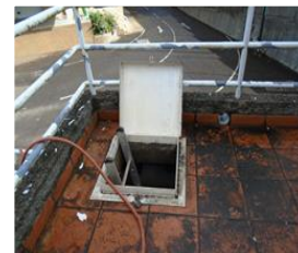
Tampa de inspeção
