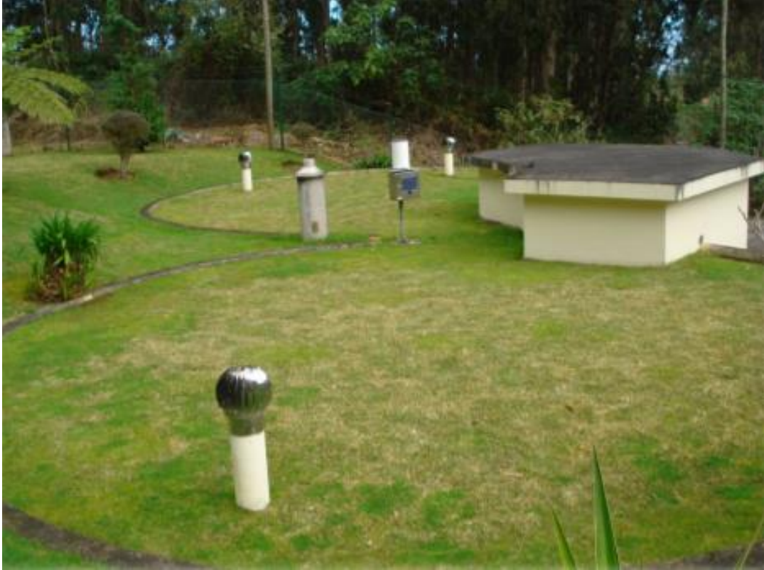
Figura 29 – Sistema de ventilação do reservatório da ETA de São Jorge, Santana (fonte: www.aguasdmadeira.pt )
