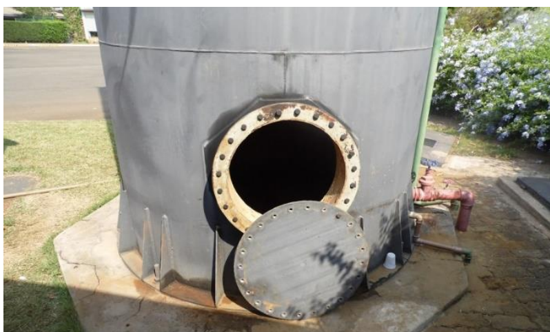
Figura 28 – Descarregador de fundo (fonte: www.cacavazamentosemguarulhos.com.br )
