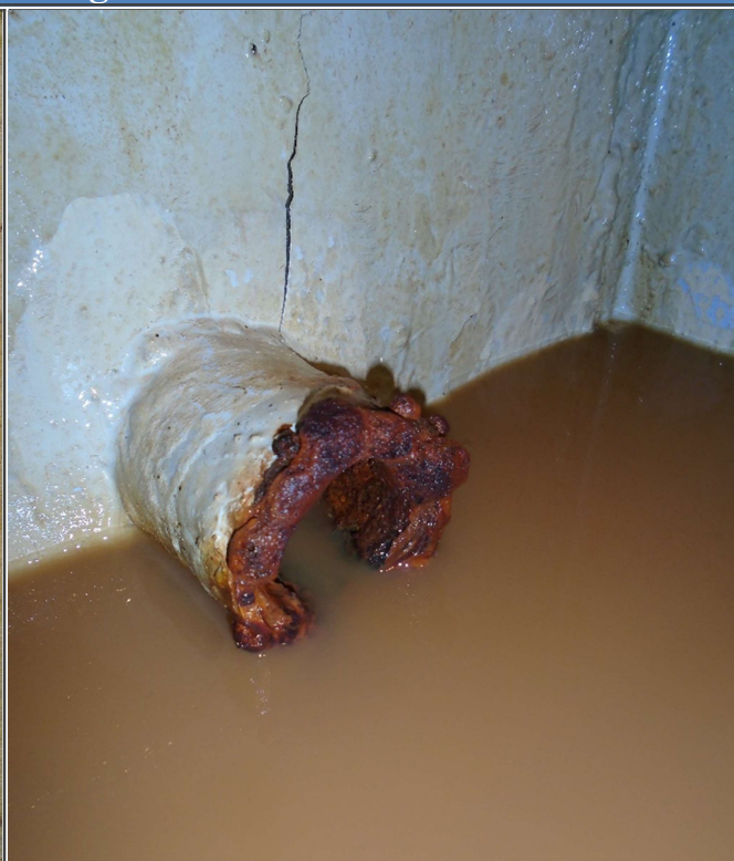
Figura 14 - Tubagem de descarga de fundo
