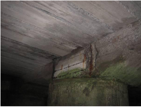
Fig. 23 – Idem. Corrosão das armaduras e delaminação do betão de recobrimento da face lateral.
