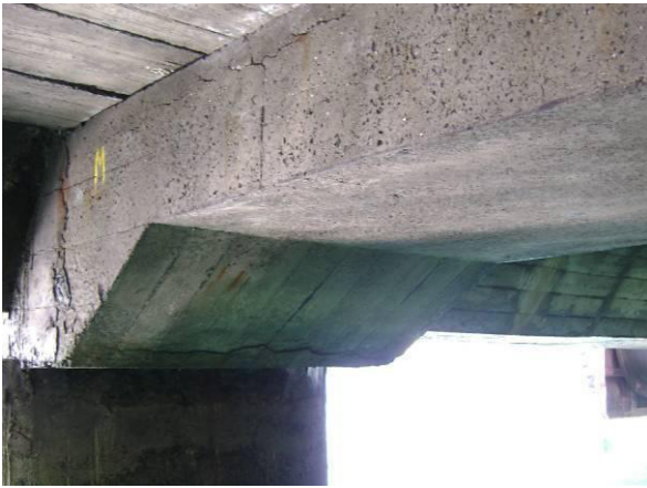
Fig. 19 – Carlinga. Fissuras de delaminação nas faces lateral e inferior.
