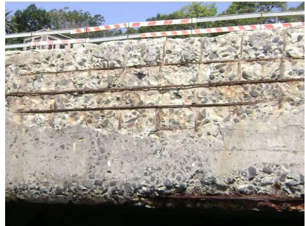
Fig. 14 – Idem. Idem. De realçar a redução da secção dos varões devido à corrosão, levando inclusivamente ao seu desaparecimento.
