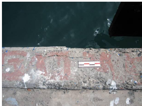
Fig. 4 – Face superior da viga de bordadura. Fissura de delaminação.
