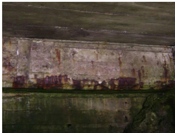
Fig. 30 – Viga de bordadura interior. Fissuras de delaminação na face lateral e manchas indiciando corrosão de armaduras.
