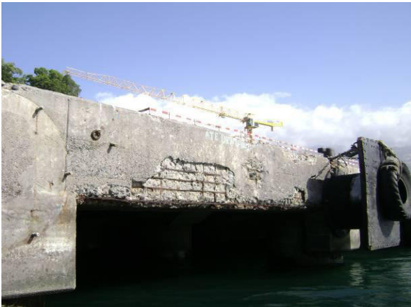
Fig. 13 – Face lateral da viga de bordadura. Corrosão das armaduras e delaminação do betão de recobrimento.
