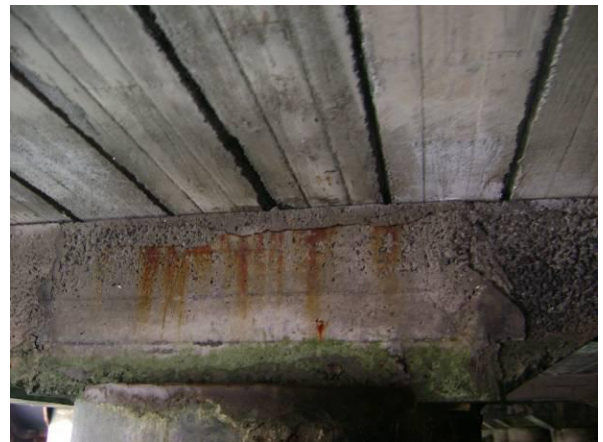
Fig. 20 – Idem. Fissura de delaminação na face lateral e manchas indiciando corrosão de armaduras.
