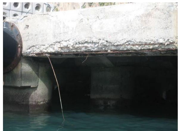
Fig. 16 – Face inferior da viga de bordadura. Corrosão das armaduras e delaminação do betão de recobrimento.
