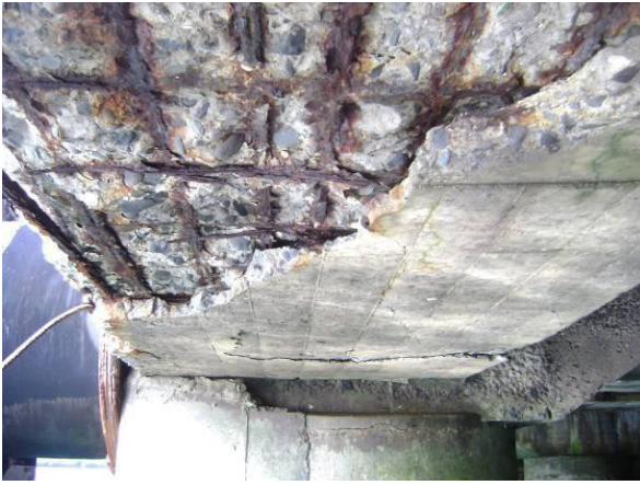
Fig. 17 – Idem. Idem. De realçar a redução da secção dos varões devido à corrosão, levando inclusivamente ao seu desaparecimento.
