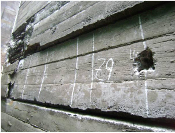
Fig. 41 – Zona de ensaios Z9 na face inferior da viga pré-fabricada da laje. Idem.
