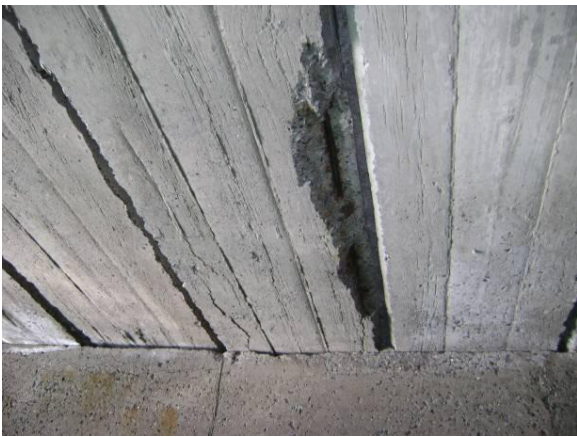
Fig. 25 – Idem. Idem e fissuras de delaminação na mesma face.
