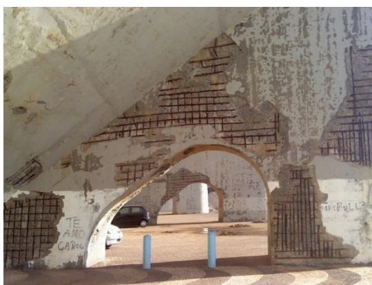
Figura 1.1 – Corrosão das armaduras nas abóbadas de contenção do aeroporto da Madeira
