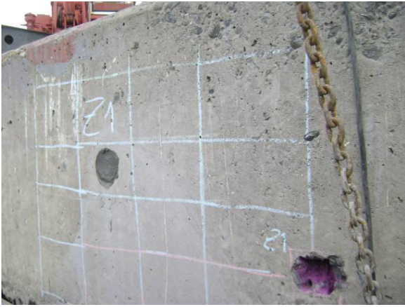
Fig. 33 – Zona de ensaios Z1 na face lateral da viga de bordadura. Disposição da malha de armaduras levantada com o detetor e sondagem para confirmação do diâmetro dos varões e medição da profundidade de carbonatação.
