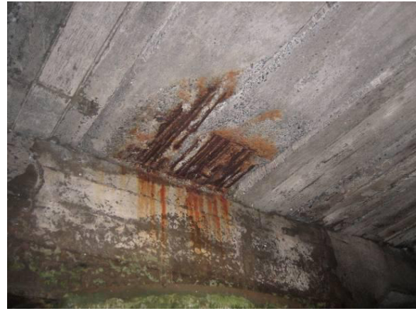
Fig. 24 – Laje constituída por vigas pré-fabricadas. Corrosão das armaduras e delaminação do betão de recobrimento da face inferior.
