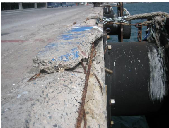
Fig. 5 – Idem. Corrosão das armaduras e delaminação do betão de recobrimento.
