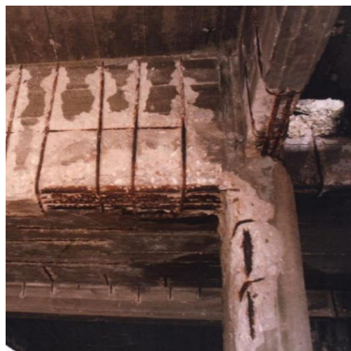
Figura 2.5 – Estrutura de betão armado contaminada pela ação da carbonatação
