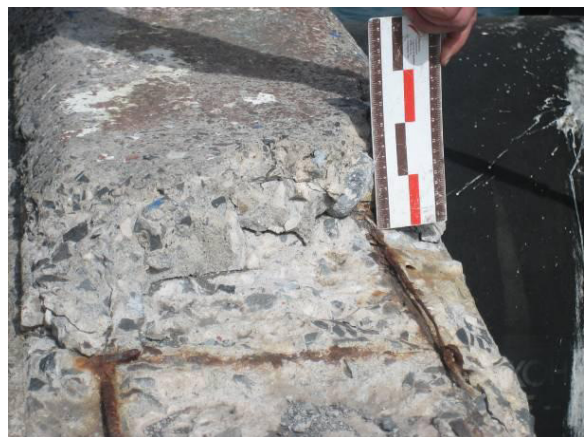
Fig. 6 – Idem. Idem. De realçar a redução da secção dos varões devido à corrosão, levando inclusivamente ao seu desaparecimento.
