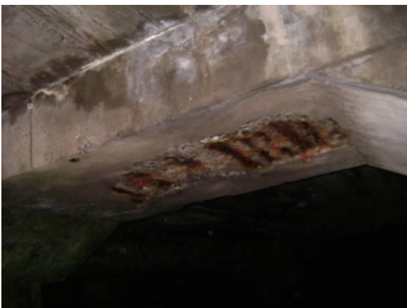
Fig. 21 – Idem. Corrosão das armaduras e delaminação do betão de recobrimento da face inferior. De realçar a ocorrência de infiltrações na laje.
