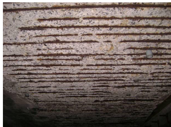
Fig. 28 – Laje maciça. Corrosão das armaduras e delaminação geral do betão de recobrimento da face inferior.
