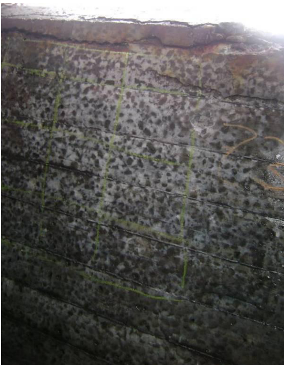
Fig. 35 – Zona de ensaios Z3 na face inferior da viga de bordadura. Idem.
