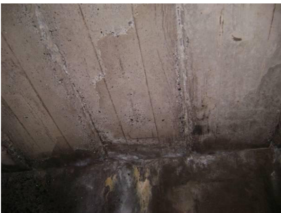
Fig. 27 – Idem. Ocorrência de infiltrações.
