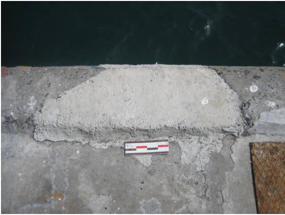
Fig. 11 – Idem. Reparação na qual aparentemente foi utilizado betão corrente.
