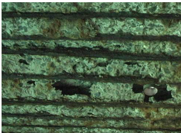
Fig. 29 – Idem. Idem. Pormenor evidenciando a delaminação do betão entre dois níveis de armadura a diferentes profundidades.
