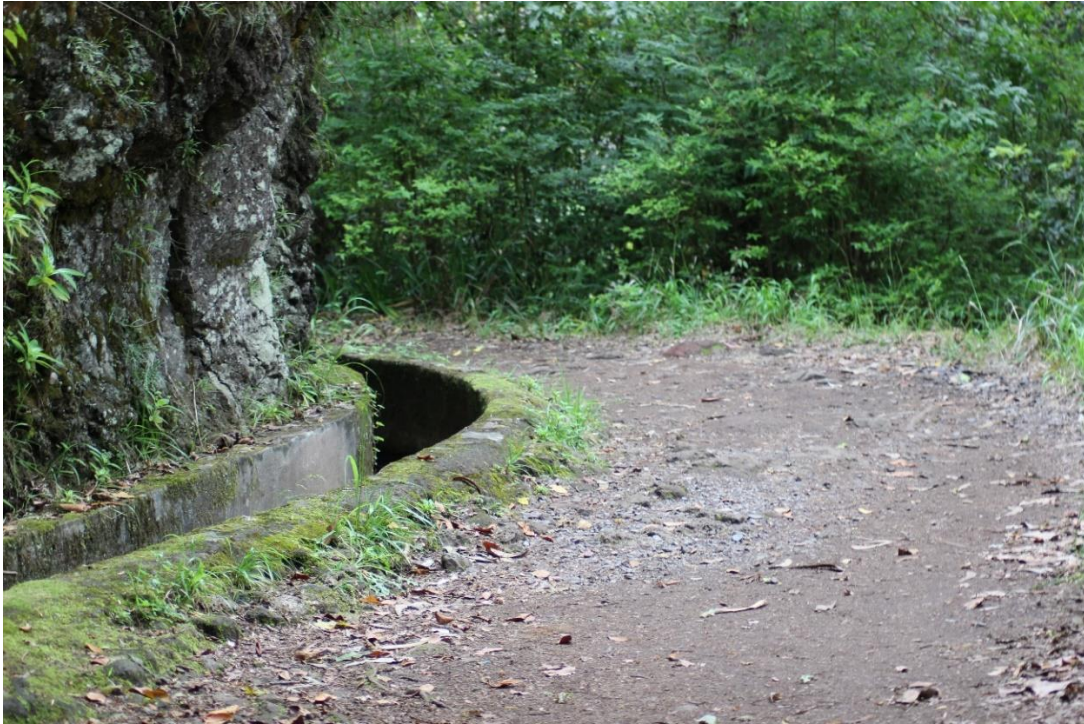
Figura 13: Percurso com sinais de degradação a nível de solo Fonte Marcos Mateus
