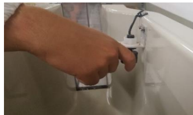
Figura 69 - Válvula de segurança a jusante
