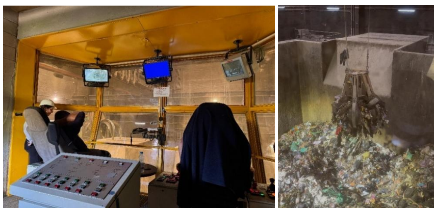
Figura 26 - Instalação de Incineração de Resíduos Sólidos Urbanos, ETRS.
