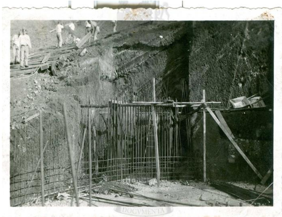
Fig. 23. Detalhe das obras de construção no Pico da Cruz, 1940. Fonte: Arquivo Histórico Militar. PT/AHM/FE/110/D4/PQ/3.
