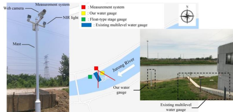
Figura 2.8 - Instalação do primeiro sistema de medição baseado em imagens no rio Jurong [15].
