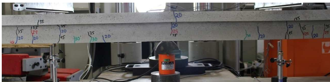
Figura 4.40 – Padrão da abertura de fendas para a viga G3b experimental, na carga de 35KN, num num carregamento dentro dos patameres de serviço
