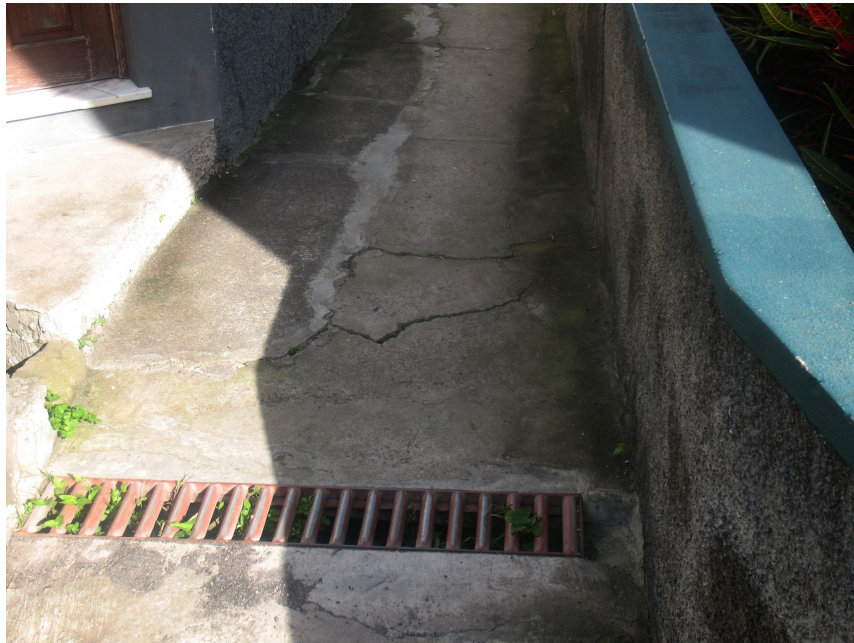
Figura 8.8 – Fissuras nos pavimentos que dão acesso às moradias afectadas pelo movimento de vertente - Casa N° 3.
