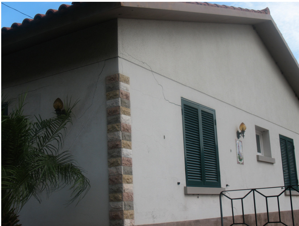
Figura 8.29 – Fissuras originadas pelo assentamento da esquina da casa - Casa Nº 13.
