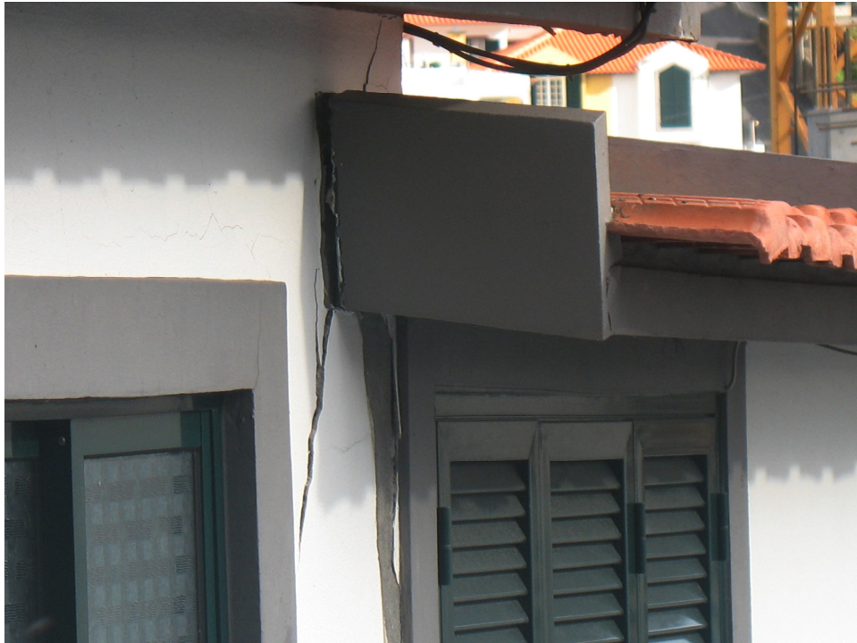
Figura 8.11 – Pode-se observar as várias fissuras provocadas pelo movimento de vertente - Casa Nº 8.
