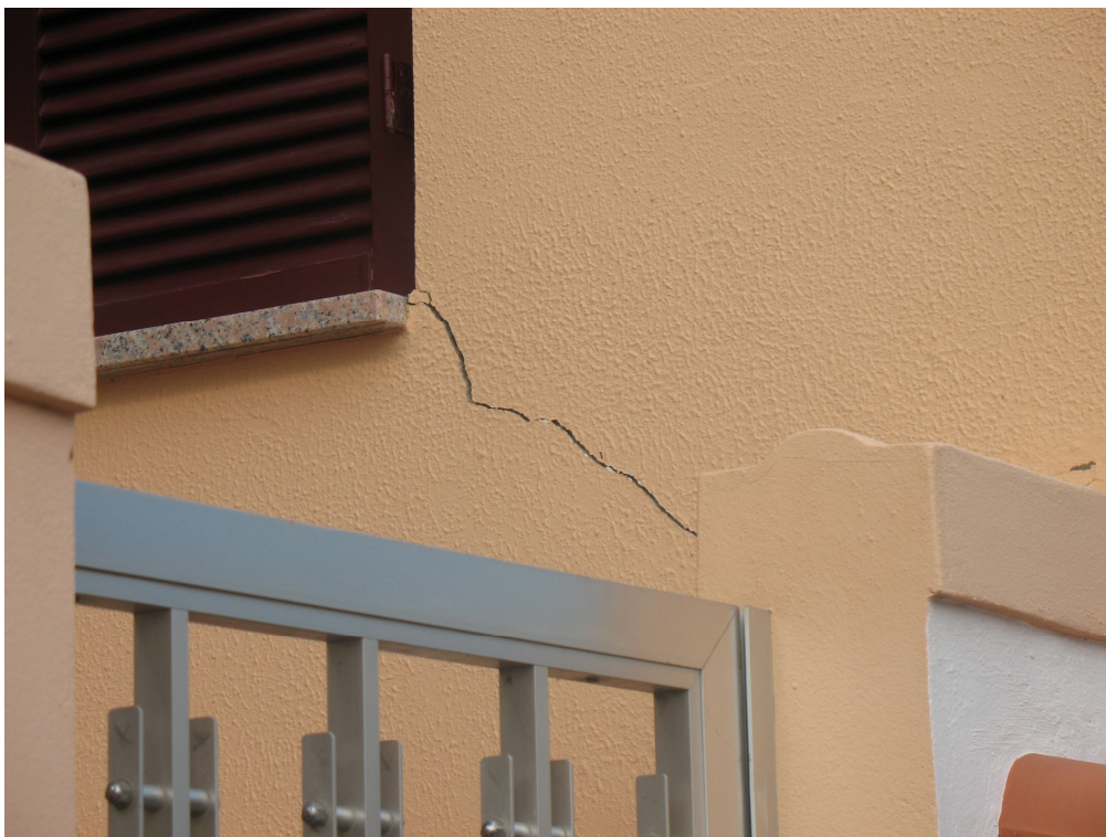
Figura 8.25 – Fissuras junto das janelas - Casa Nº 6.
