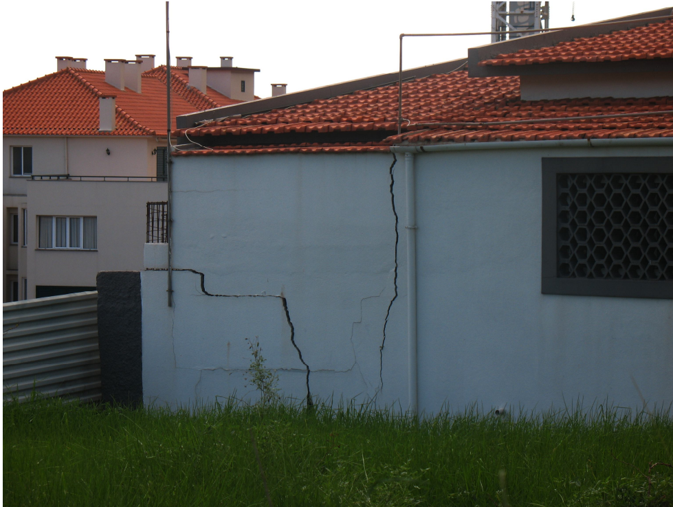
Figura 8.32 – Assentamento excessivo da esquina da casa - Casa Nº 8.
