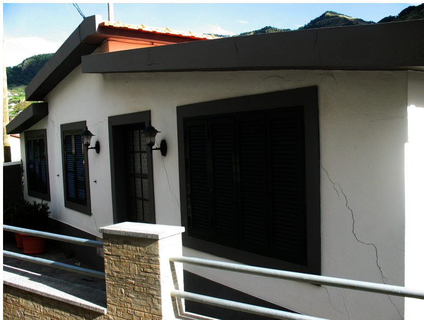
Figura 8.10 – Pode-se observar as várias fissuras provocadas pelo movimento de vertente – Casa Nº 8.
