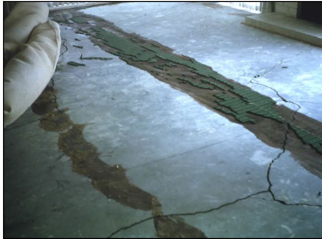
Figura 10.8 – Danos no ensoleiramento devido a drenagem deficiente (Rogers, 2003).
