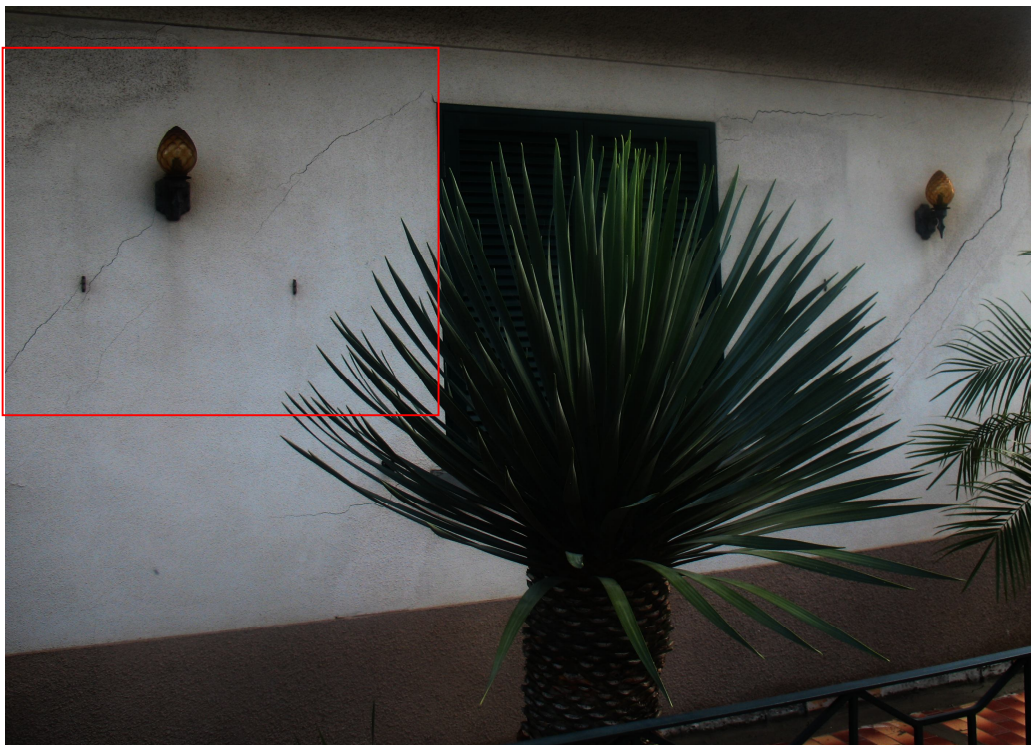
Figura 8.23 – Fissuras diagonais em forma de escadinha - Casa Nº 13.
