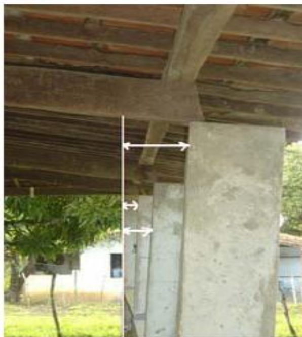
Figura 1.8 - Inclinação de pilares devido a expansão do solo de fundação – Município de Santo Amaro – SE (Cavalcante et al., 2006).
