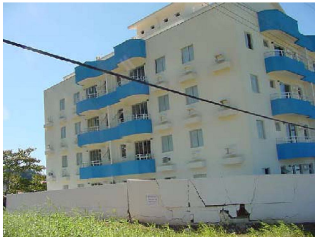
Figura 2.16 – Nesta imagem podemos observar as fissuras no muro provocadas pela compressão do
