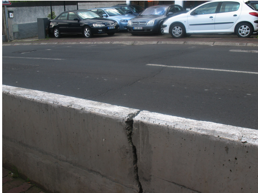
Figura 8.9 – Pode-se observar as fissuras provocadas pelo movimento de vertente que partiu o muro e continuou a prolongar-se ao longo da estrada.
