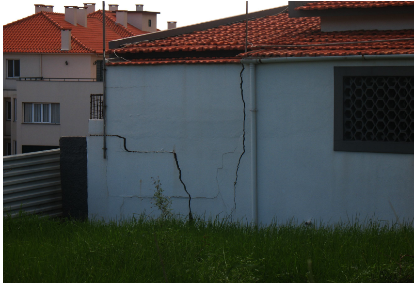
Figura 8.13 – Pode-se observar as várias fissuras provocadas pelo movimento de vertente - Casa Nº 8.
