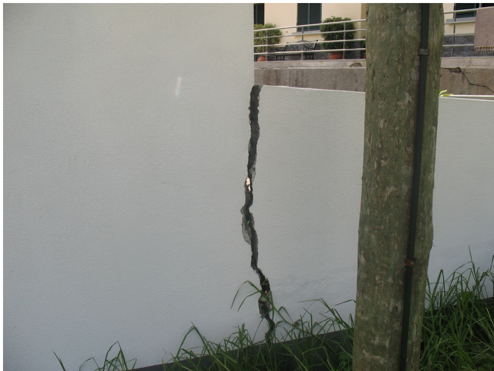
Figura 8.12 – Pode-se observar as várias fissuras provocadas pelo movimento de vertente - Casa Nº 8.
