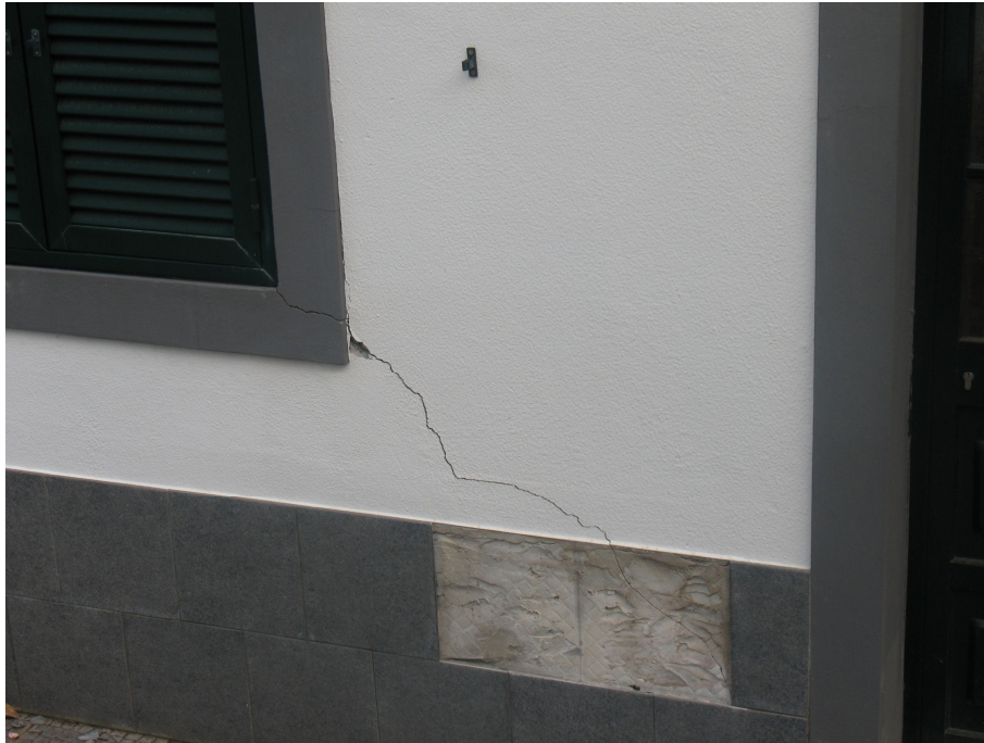
Figura 8.26 – Fissuras junto das janelas - Casa Nº 8.
