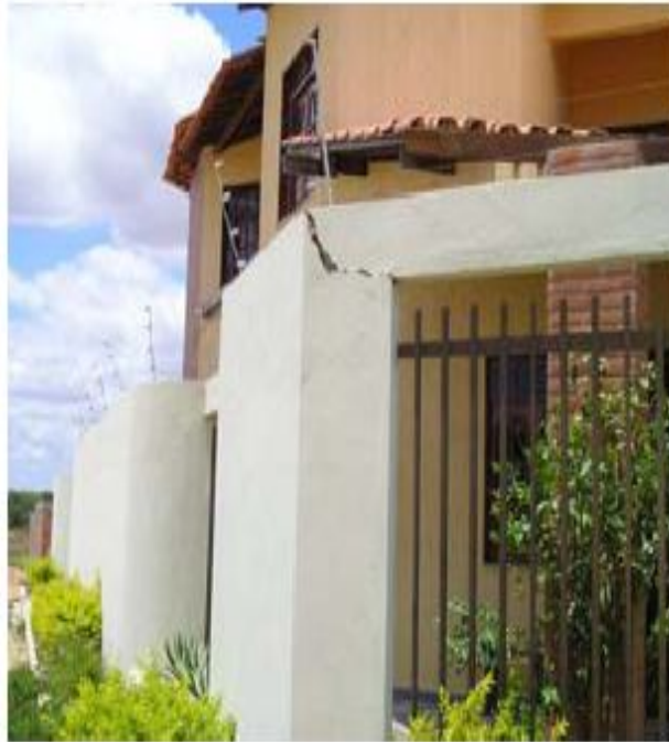
Figura 1.7 - Ruptura de um pórtico causada por expansão de solos – Município de Poço Verde – SE (Cavalcante et al., 2006).
