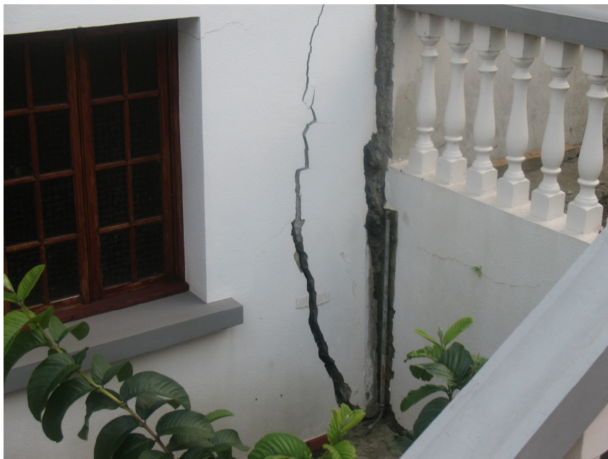
Figura 8.14 – Pode-se observar as várias fissuras que provocaram a separação das casas - Casa Nº 14/15.
