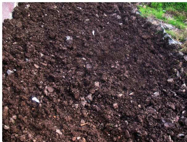
Figura 8.4 – Durante a escavação na obra pode-se observar que o solo encontra-se molhado.
