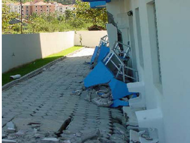
Figura 2.15 – Nesta imagem podemos observar o assentamento do prédio (Maffei Engenharia, Gimenez de Souza, 2003).
