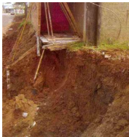
Figura 4.5 – Descalçamento das fundações da estrutura devido a escavações próximas (Schnaid, 2006).
