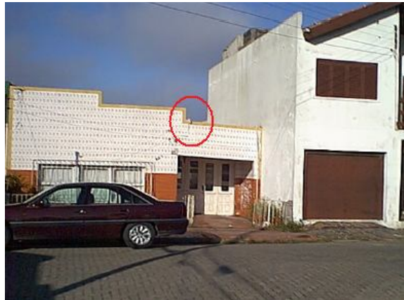
Figura 4.2 – Problemas causados pela construção de novas estruturas sem junta de separação (Schnaid, 2006).
