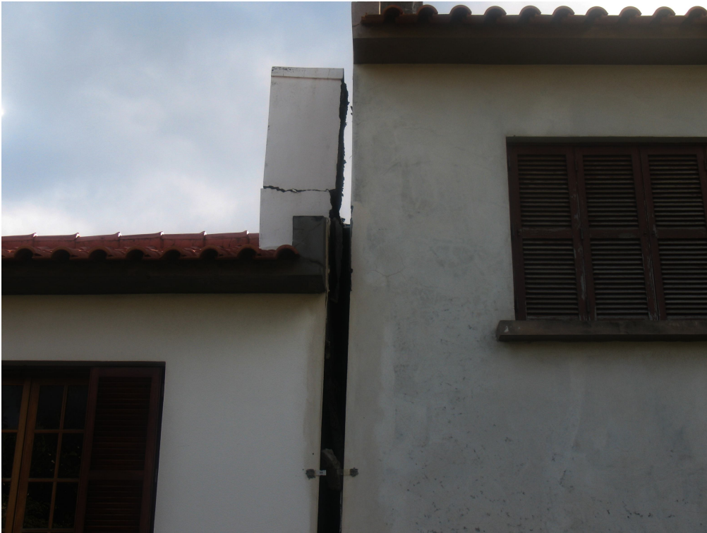
Figura 8.15 – Pode-se observar a separação das duas moradias devido ao movimento do solo - Casa Nº 14/15.
