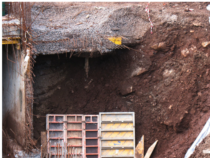
Figura 8.2 – Durante a escavação na obra pode-se observar que o solo encontra-se molhado.
