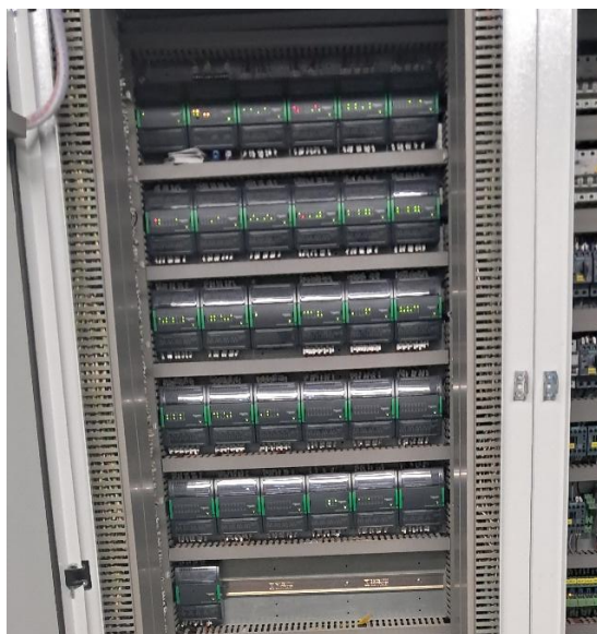
Figura 73. Quadro de automação do Hotel The Views Oásis .
