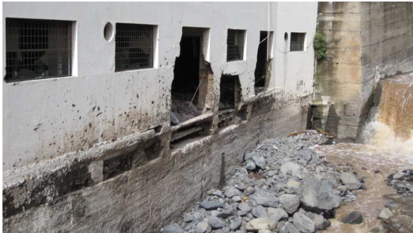
Figura 63: Danos na auto Lavagem de São João Fonte: SRES
