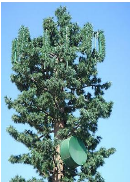
Fig. 5-11 Torre de comunicações camuflada.
