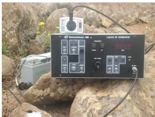
Fig. 5 Transmissor VHF instalado alimentada por uma bateria de 12 Volts
