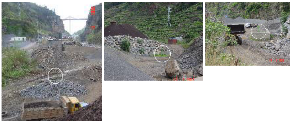
Figura 22 – Furo 3 da Ribeira dos Socorridos
