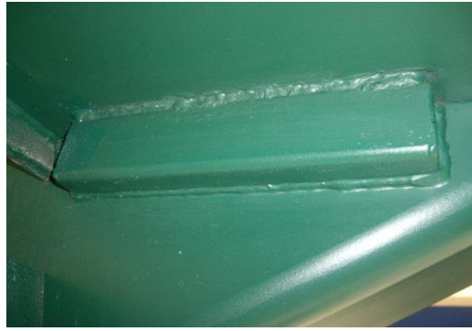
Figura C.3 – Pormenor de ligação por meio de soldadura entre os degraus e as longarinas
