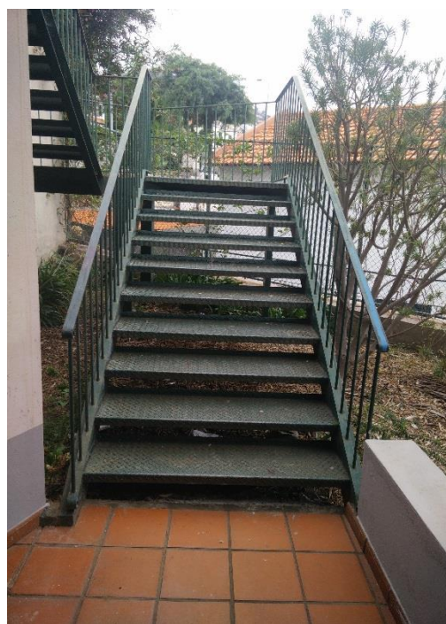
Figura D.24 – Escada metálica Escola Básica dos 2º e 3º Ciclos dos Louros, Funchal, Madeira
