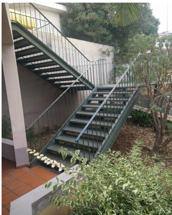
Figura D.23 – Escada metálica Escola Básica dos 2º e 3º Ciclos dos Louros, Funchal, Madeira
