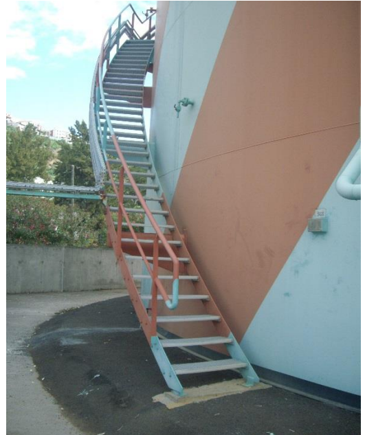
Figura D.18 – Escada metálica Empresa de Electricidade da Madeira (EEM), Câmara de Lobos
