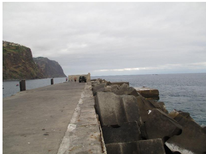
Figura 7 - Parte da superestrutura sem muro cortina, destruído pela agitação marítima (maio de 2013).
