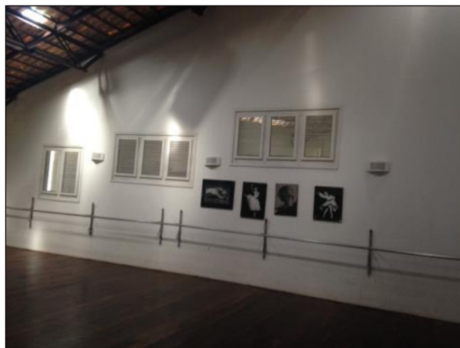
Foto 15 - Sala de aula com telha deslocada
