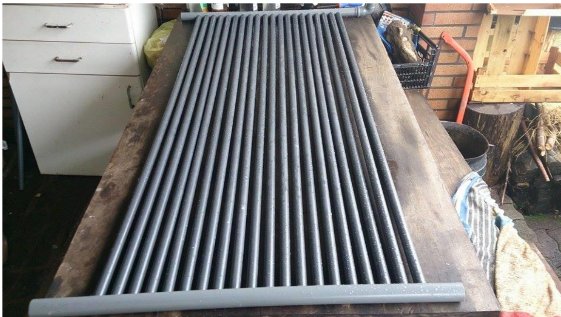
Figura 43 Tubagem PVC montada
