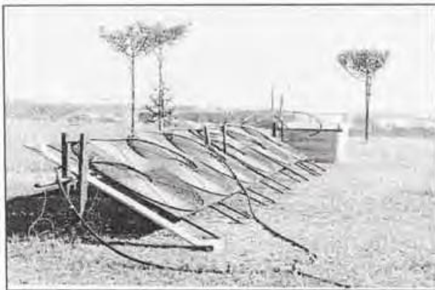
Figura 15 Coletor com tubagem de polietileno
