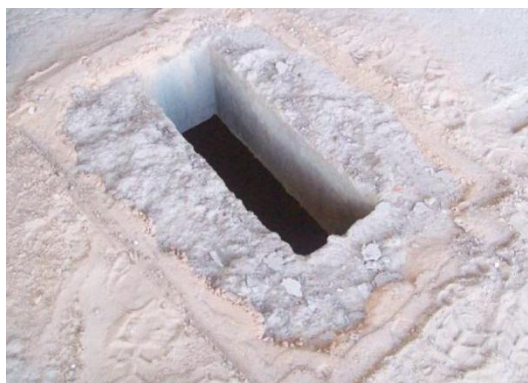
Figura 64 - Negativo que terá que ser fechado, por uma deficiente compatibilização entre as coretes definidas no projeto de arquitetura e as definidas no projeto das instalações hidráulicas, (reproduzido de Sousa, 2010).
