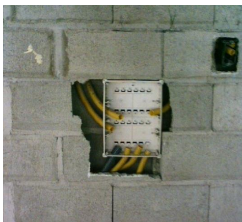
Figura 66 - Exemplo de uma deficiente preparação da parede que acolhe o quadro elétrico, (reproduzido de Faria, 2007).
