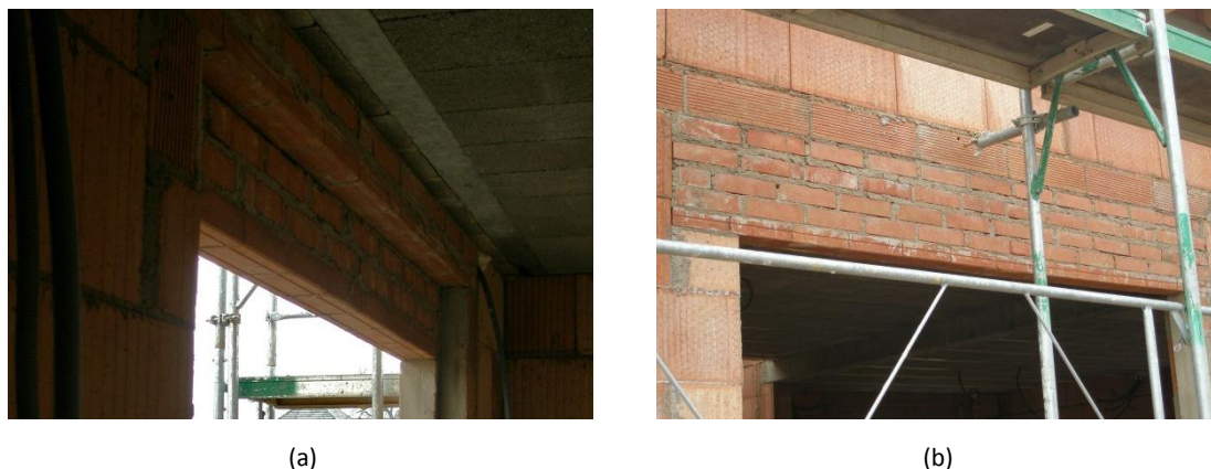
Figura 20 - Lumieiras preparadas para colocação de estores elétricos; (a) Vista interior; (b) Vista exterior.
