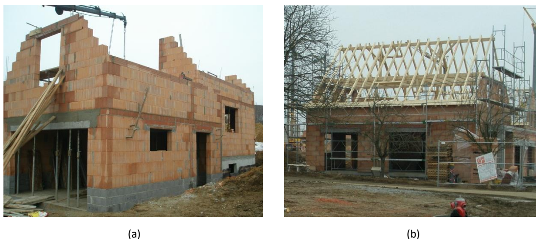
Figura 25 - Execução da estrutura para a cobertura; (a) Elevação das paredes de alvenaria estrutural; (b) Estrutura em madeira já colocada.
