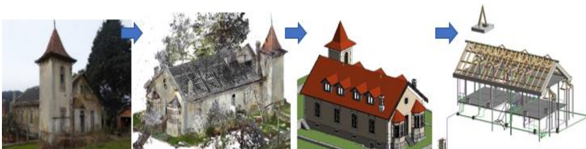
Figura 33 - Casa do Médico, levantamento, modelo BIM e modelo de Especialidades (adaptado de [29]).
