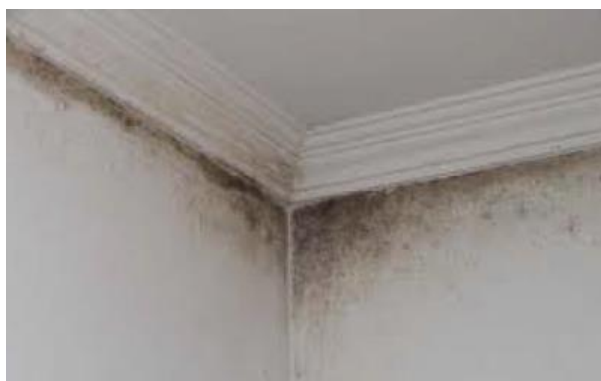
Figura 74 - Condensação nas paredes (Carvalho, 2015)
