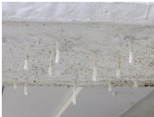
Figura 75 - Humidade devida a fenómenos de higroscopicidade dos materiais (Guimarães, 2012)
