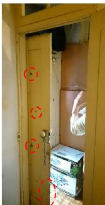
Figura 55 - Anomalia V-12 (Portas interiores)
