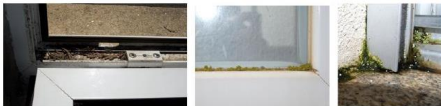
Figura 82 - Acumulação de folhas no caixilho (à esquerda) e colonização biológica na face exterior da caixilharia (ao centro e à direita) (Santos, 2012)
