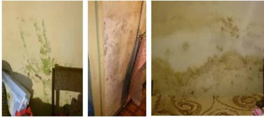
Figura 47 - Anomalias PI/T-2, PI/T-3, PI/T-4, PI/T-6 e PI/T-11 (paredes interiores da habitação)
