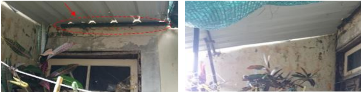
Figura 41 - Anomalias PE-3, PE-9, PE-14 e PE-15
