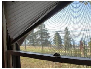
Figura 83 - Degradação de estores (Santos A. J., 2012)
