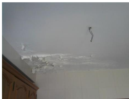
Figura 19 - Infiltrações provenientes da cobertura (Guimarães, 2012)
