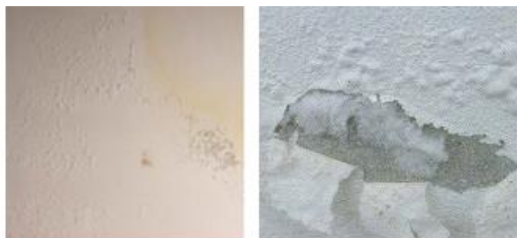
Figura 21 - Eflorescências (à esquerda) e Criptoflorescência (à direita)
