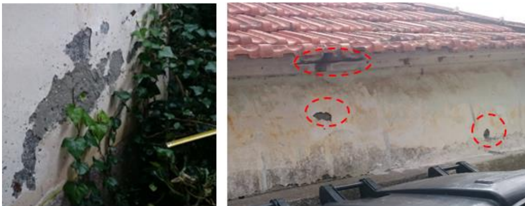
Figura 42 - Anomalias PE-5, PE-7, PE-8 e PE-10
