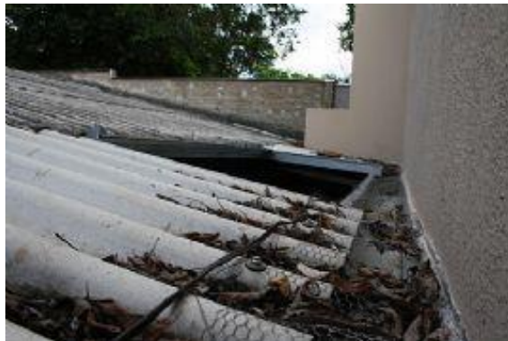
Figura 76 - Humidade devida a causas fortuitas - calhas entupidas que levam à acumulação de água, que posteriormente é absorvida pelas paredes (Fábio Silva et.al., 2012/2013)
