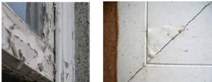
Figura 84 - Descamação da pintura - caixilharia de madeira (à esquerda) (Freitas, 2006, citado por Santos, 2012) e empolamento da lacagem - caixilharia de alumínio (à direita) (Amtec, 2012 citado por Santos, 2012)
