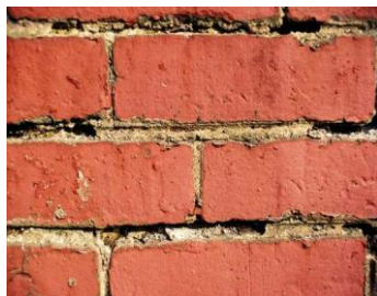
Figura 69 - Humidade de construção a degradar os tijolos (Santos & Soares, 2012)
