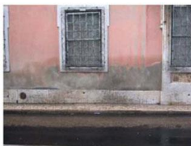
Figura 70 - Humidade do terreno (Reabilitação e Manutenção de Edifícios, 2016)
