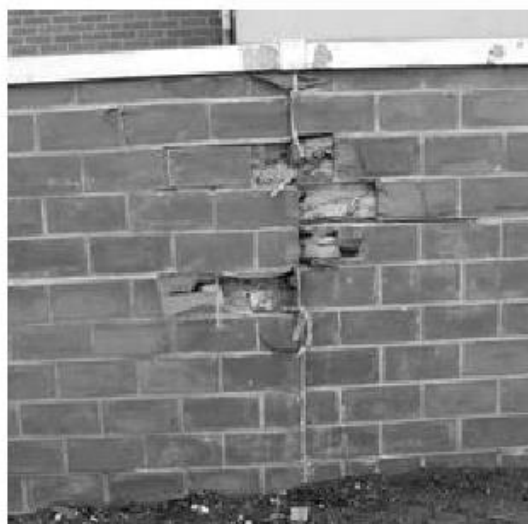
Figura 16 - Esmagamentos (Patologia das Edificações, 2016)
