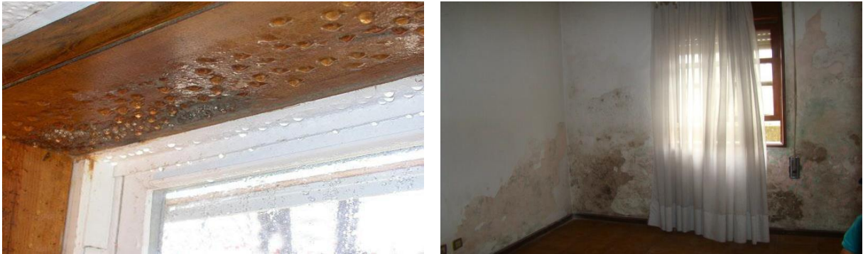
Figura 22 - Humidade de condensação (à esquerda) e do terreno (à direita) (Linhares & Castro, 2012)
